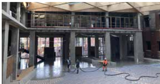
○ Travaux dans le bâtiment Pollet, qui reprend des éléments récupérés sur d'autres chantiers.
